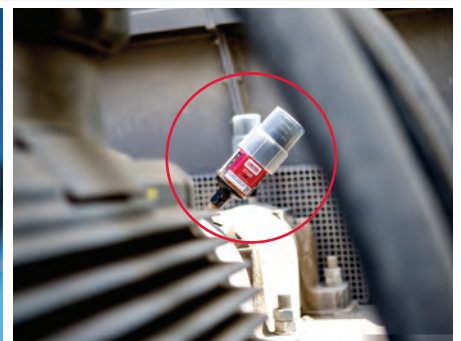
Bearing lubrication on a fan
